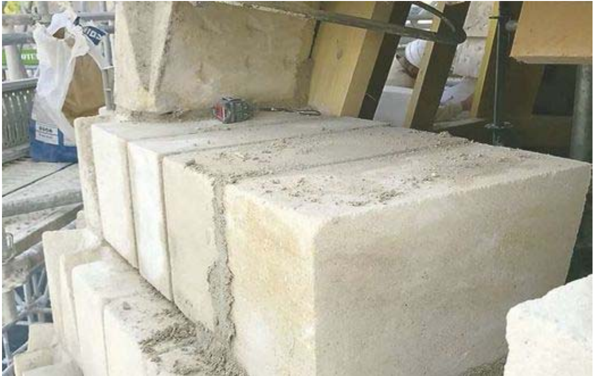
Les blocs de tuffeau ont été remplacés par de la pierre de Sireuil, plus dure et moins poreuse. - © PHOTOS : CHRISTOPHE BATARD / AGENCE 2BDM
