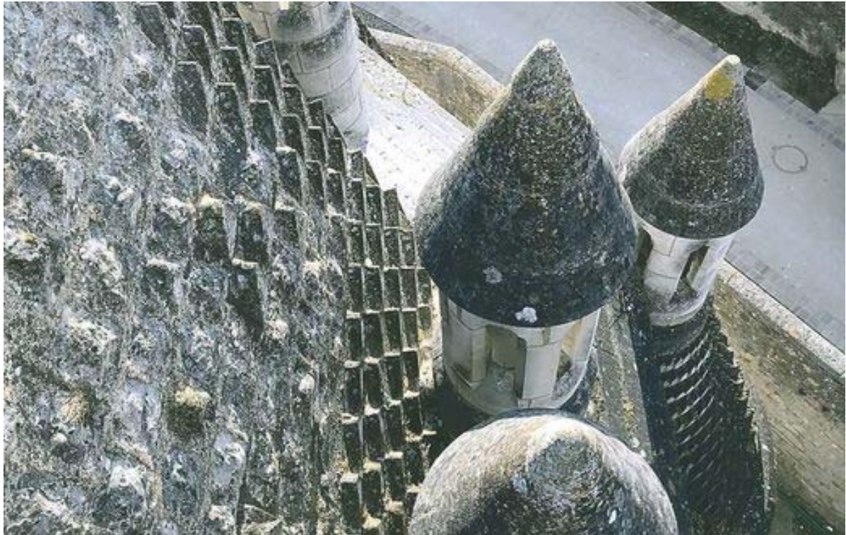
De très nombreuses zones de l'édifice étaient atteintes, d'où le choix de remplacer les pierres de tuffeau malgré leur valeur archéologique.
