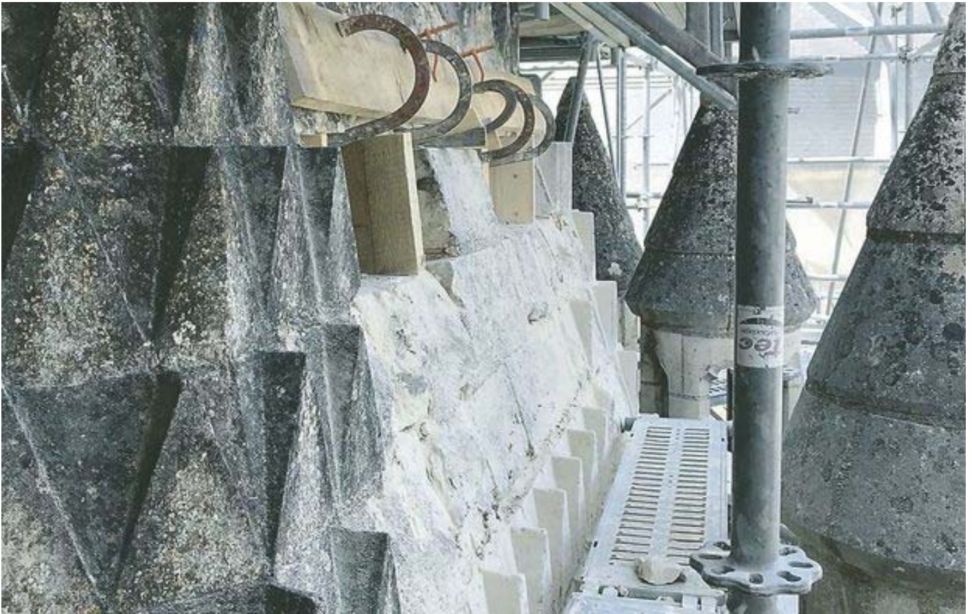
Les pierres de la toiture, rongées par l'humidité, se desquamaient - © PHOTOS : CHRISTOPHE BATARD / AGENCE 2BDM
