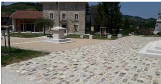
L'aménagement de la place de la mairie de Varacieux (38) a été réalisé avec 600 m 2 de pavés Fontainebleau de chez Noblema. Ce sont des pavés grès ancien de récupération, de format 15 x 15 cm à 17 x 17 cm de teinte beige clair. Ils ont des formes irrégulières et une patine incomparable.
