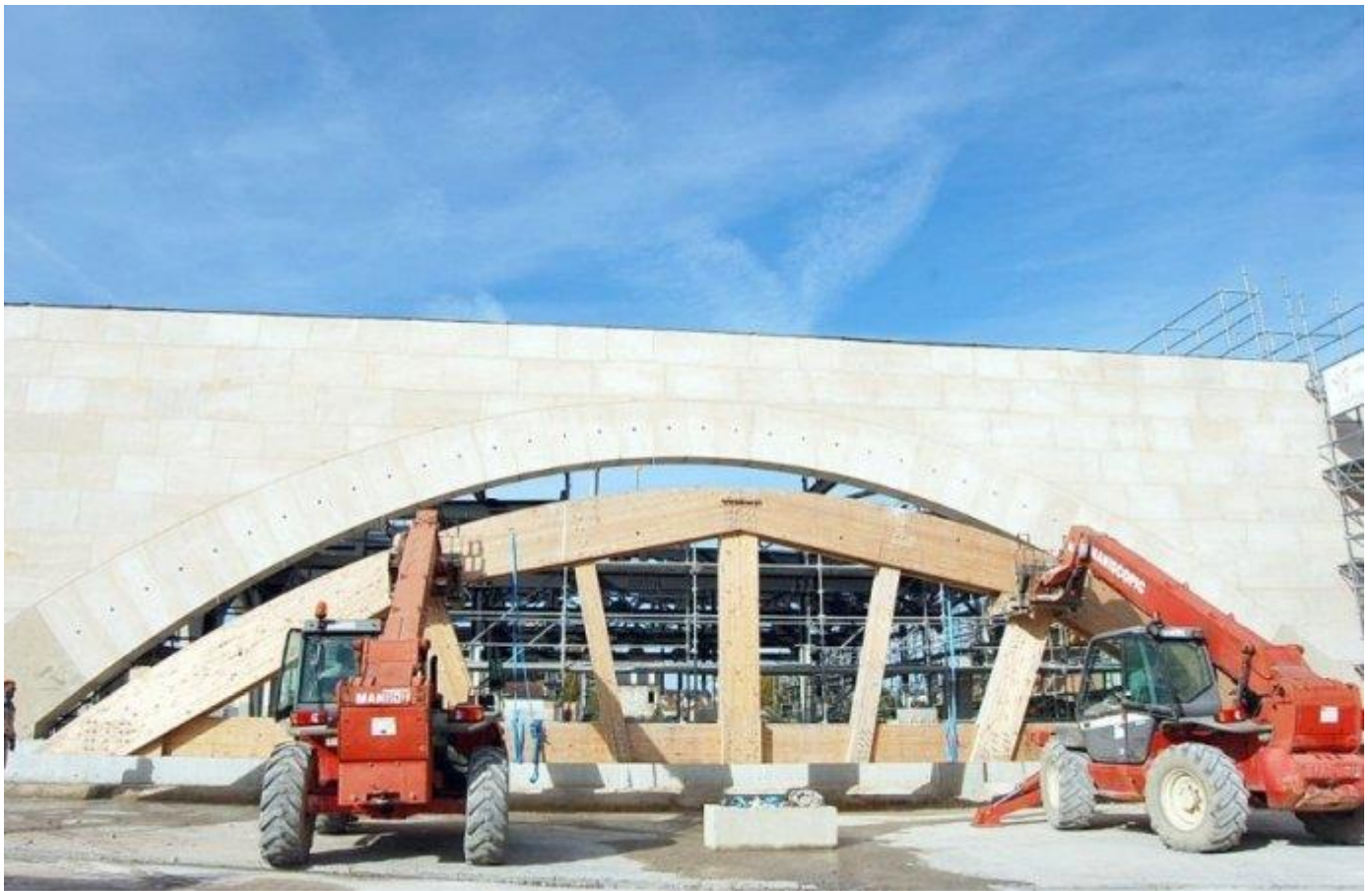
Les opérateurs à la manoeuvre du décoffrage ont fait preuve d'une grande précision. - Photo : Frédérique Daoust
